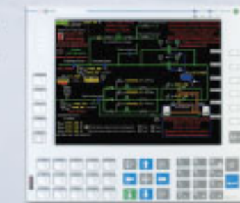
Локальный пульт оператора
